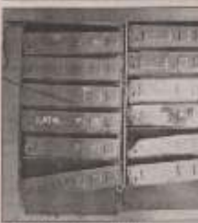
Неудовлетворительное состояние абонентских почтовых шкафов уже длительное время волнует
