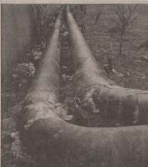
Ось в ТАКОМУ КАТАСТРОФИЧНОМУ І ГАЛЕНЬКОМУ СТАНІ ЗНАХОДИТЬСЯ ВСЯ ВОДА ТА ТЕПЛО МЕРЕЖКА ТЯЧЕВА І РАЙОНУ.
